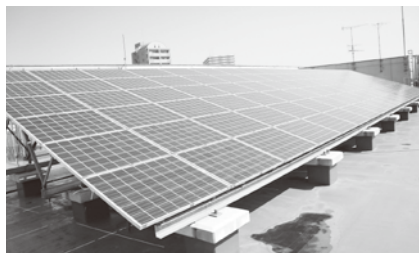
田無庁舎太陽光発電装置(南町5丁目)
