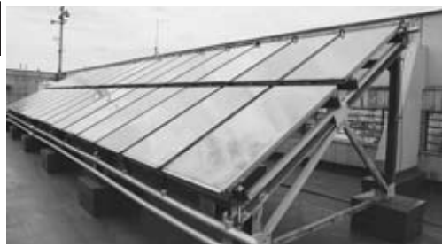
太陽光発電システム(田無庁舎屋上)
