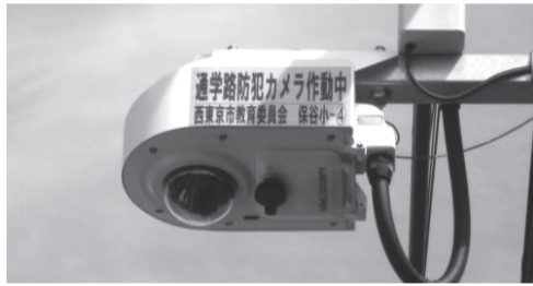
通学路に設置されている防犯カメラ
