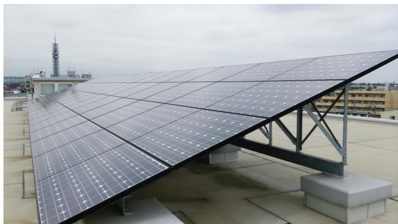
公共施設の太陽光発電システム
